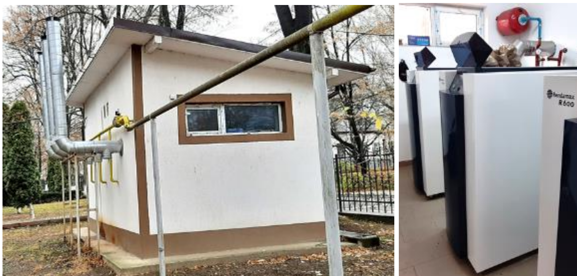
Fig. 5.42. Școala Gimnazială "Ștefan cel Mare" Vaslui - Centrala termică
