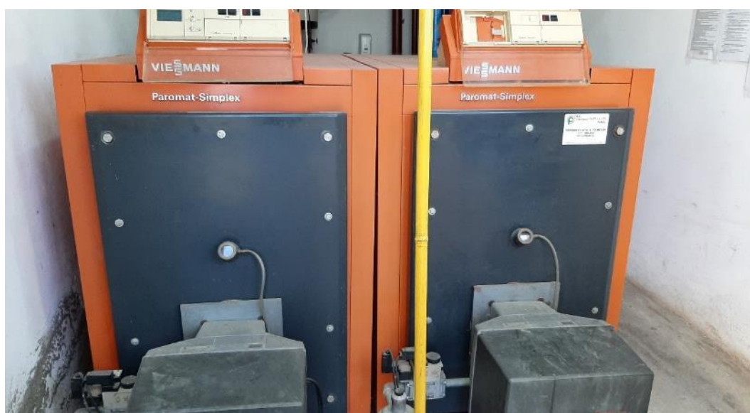
Fig. 5.57. Școala Gimnazială "Mihail Sadoveanu" Vaslui - Centrala termică (2 cazane Viessmann Paromat Simplex)
