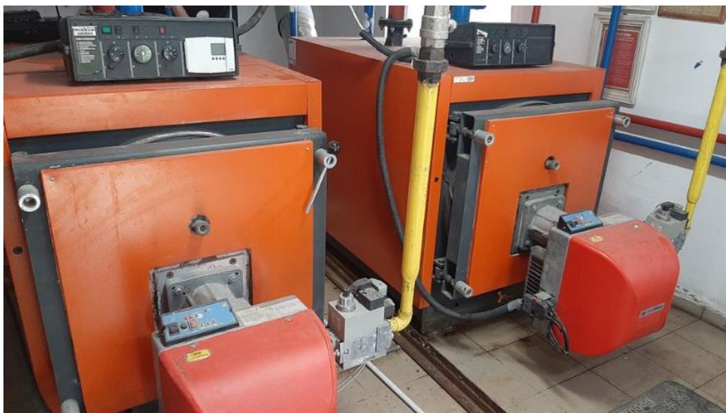
Fig. 5.23. Liceul Tehnologic "Emil Racoviță" Vaslui - Centrala termică
