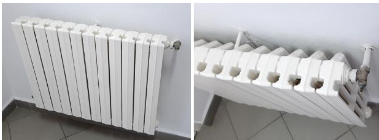
Fig. 5.45. Școala Gimnazială "Mihai Eminescu" Vaslui - calorifere din fontă, cu rețeaua de distribuție agent termic îngropată în perete
