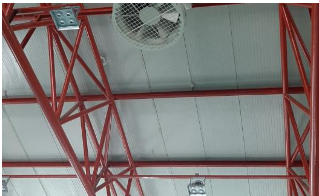
Fig. 5.20. Liceul Tehnologic “Ion Mincu” Vaslui - instalații de iluminat interior (proiectoare) cu LED în sala de sport
