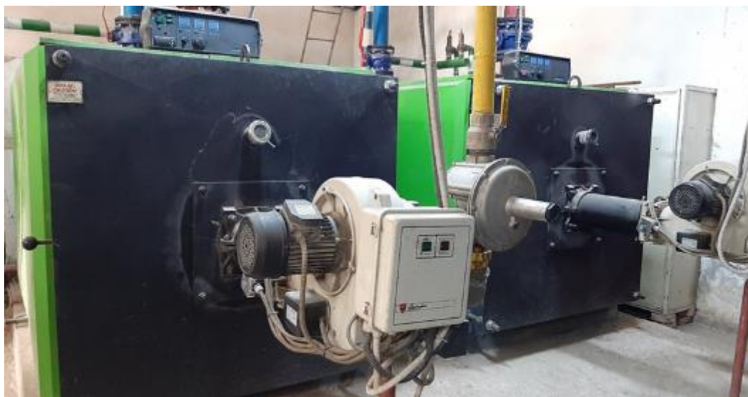
Fig. 5.13. Grupul Școlar Industrial "Ștefan Procopiu" Vaslui - Centrala termică
