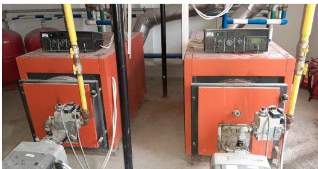
Fig. 5.52. Școala Gimnazială "Alexandra Nechita" Vaslui - Centrala termică (2 cazane ARCA MK170)
