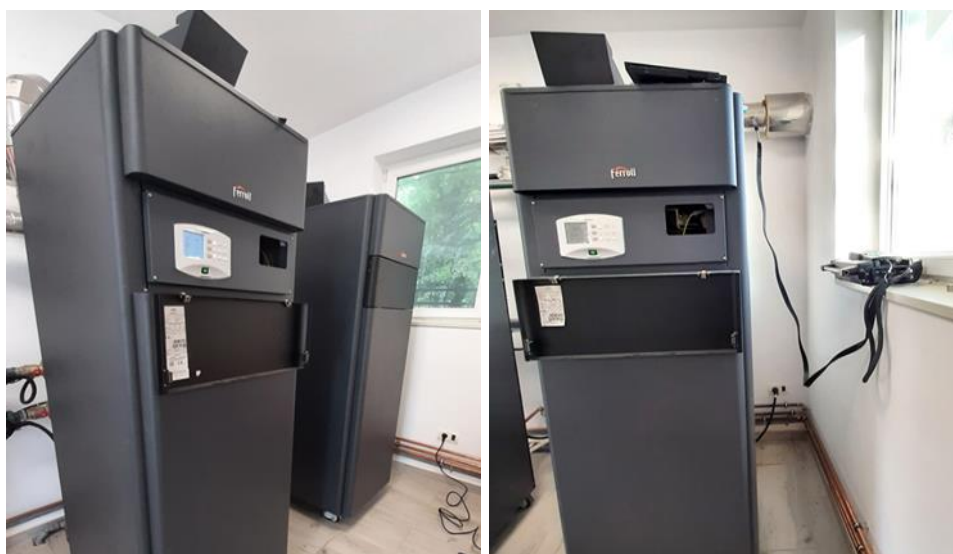
Fig. 5.35. Școala Gimnazială "Constantin Parfene" Vaslui - Centrala termică (cazane în condensare). Măsurători efectuate la cazane (analiză gaze de ardere)
