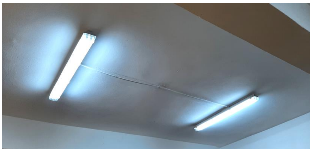
Fig. 5.14. Grupul Școlar Industrial "Ștefan Procopiu" Vaslui - instalații de iluminat interior tip 2x36W fluorescent
