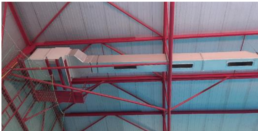
Fig. 5.39. Școala Gimnazială "Elena Cuza" Vaslui - Aerotermă cu gaze naturale și tubulatură de distribuție aer cald la Sala de sport
