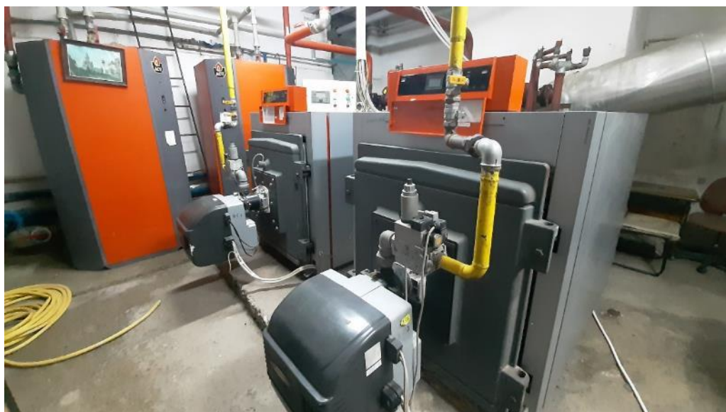
Fig. 5.3. Colegiul Economic "Anghel Rugină" Vaslui - Centrala termică
