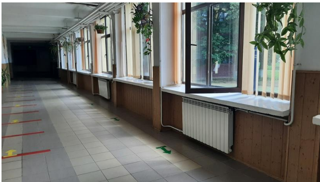
Fig. 5.24. Liceul Teoretic “Emil Racoviță” Vaslui - instalații interioare de încălzire cu radiatoare din aluminiu
