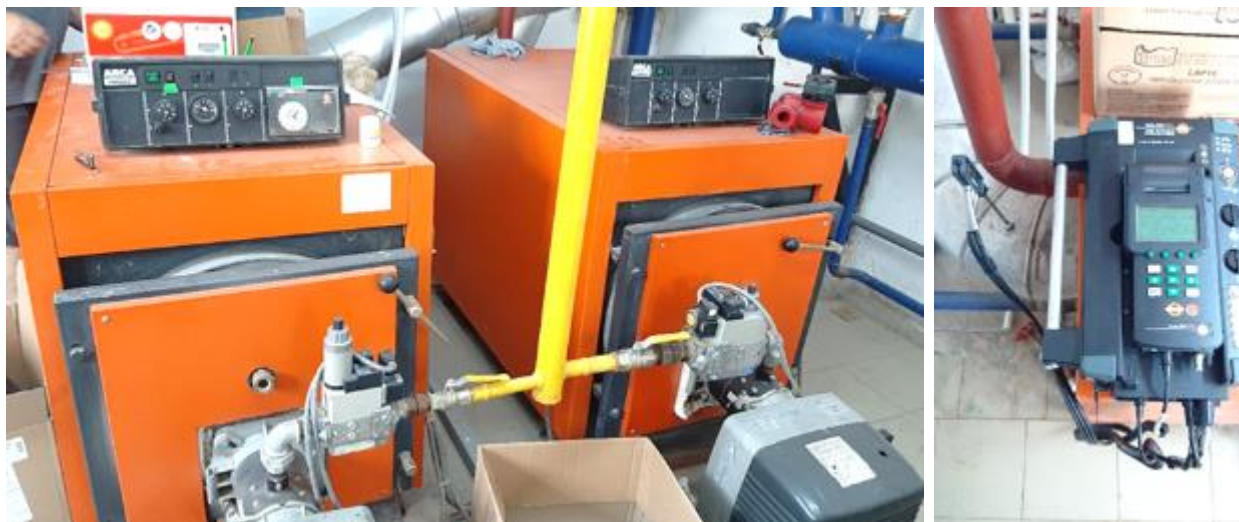
Fig. 5.49. Școala Gimnazială "Constantin Motaș" Vaslui - Centrala termică echipată cu 2 cazane ARCA PRK 350. Măsurători efectuate la cazane (analiză gaze de ardere)
