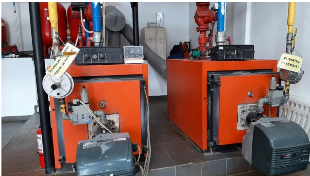
Fig. 5.18. Liceul Tehnologic “Ion Mincu” - Centrala termică pentru Corp A, Corp B, Corp C și Cantină (cazane cu tiraj forțat)
