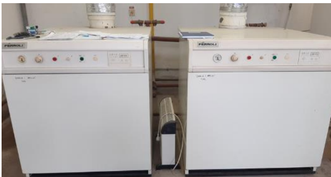
Fig. 5.31. Școala Gimnazială "Al. I. Cuza" - Centrala termică echipată cu 2 cazane Ferolli PEGASUS F3 (136 kW și 119 kW)
