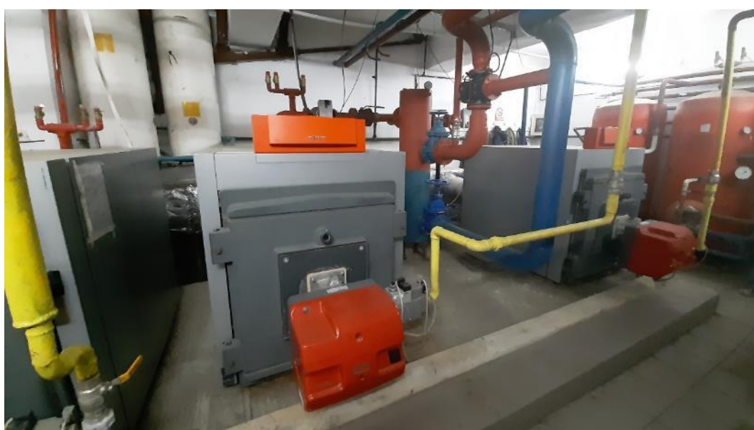
Fig. 5.6. Liceul Teoretic "M. Kogălniceanu" Vaslui - Centrala termică
