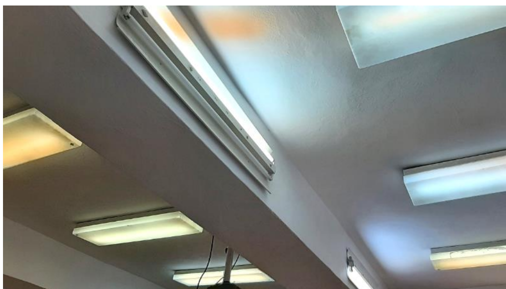
Fig. 5.4. Colegiul Economic "Anghel Rugină" Vaslui - instalații de iluminat interior
