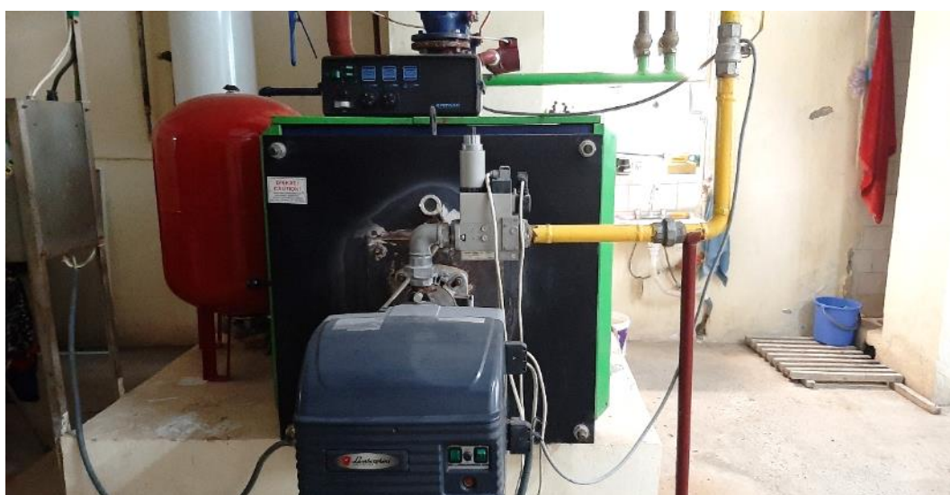
Fig. 5.38. Școala Gimnazială "Elena Cuza" Vaslui - Centrala termică de la corp Școală
