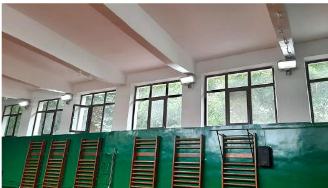
Fig. 5.25. Liceul Teoretic “Emil Racoviță” Vaslui - instalații de iluminat interior tip proiectoare cu LED în sala de sport
